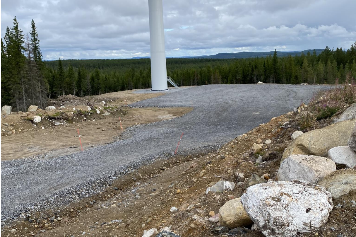
Figur 16. Exempel på hur en färdig kranplats kan se ut. Närmast i bild har marken grävts ur och längst bort i bild har marken byggts upp för att skapa en plan yta. Foto från Markbygden ©Wind Sweden
